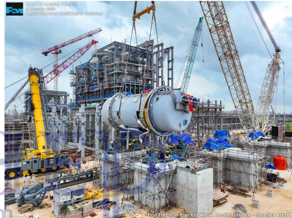
Foto 2. Instalasi tungku anoda
